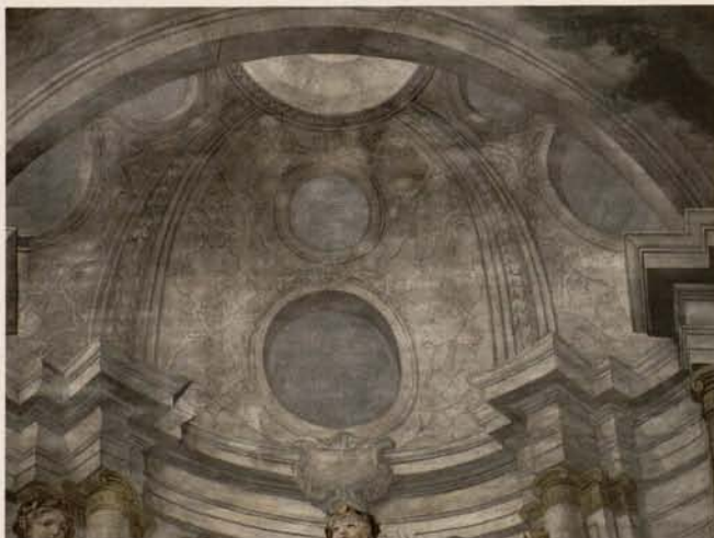
Abb. 1. Kisslegg, Kath. Pfarrkirche: Verschmutzung durch ein ungesteuertes Umluftheizsystem.
