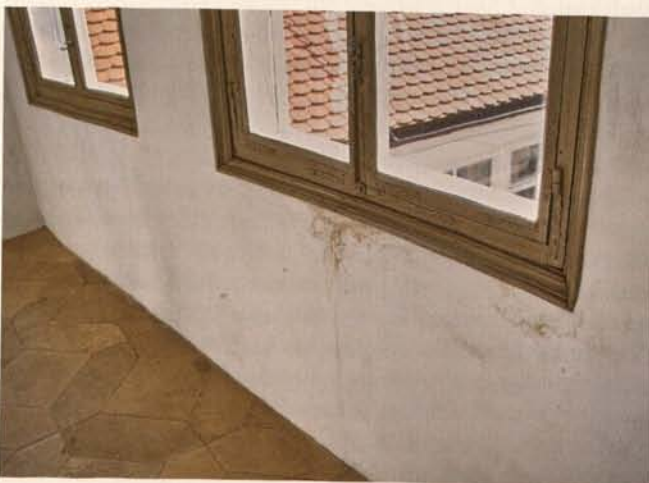
Abb. 6. Nürnberg, Johannisstraße 19, Saal im Dachgeschoss: Feuchteschäden im Bereich restaurierter Fenster (2004).
