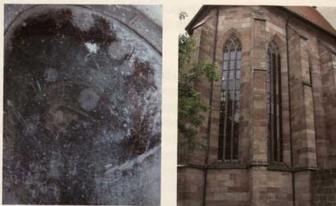
Abb. 7a-b. Nürnberg, Frauenkirche: Glaskorrosion durch Schimmelpilze an sehr widerstandsfähigen Renaissance-Gläsern (a) und Einbau einer Schutzverglasung mit Isolierglas (b).
