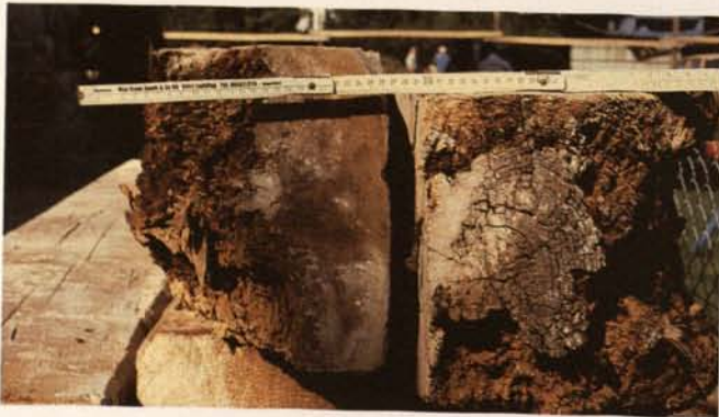
Abb. 3. Infolge Kondensation zerstörter Holzbalkenkopf einer Saaldecke.
