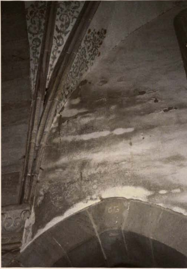
Abb. 9. Lorch, ehem. Klosterkirche, nördliches Seitenschiff: fortwährende Durchfeuchtung der West-Wand durch Regenwasser aufgrund einer verstopften Regenrinne.
