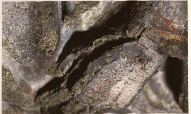
Abb. 6. Schwäbisch Gmünd, Heilig-Kreuz-Münster, Südportal, Detail Schadensbild.
