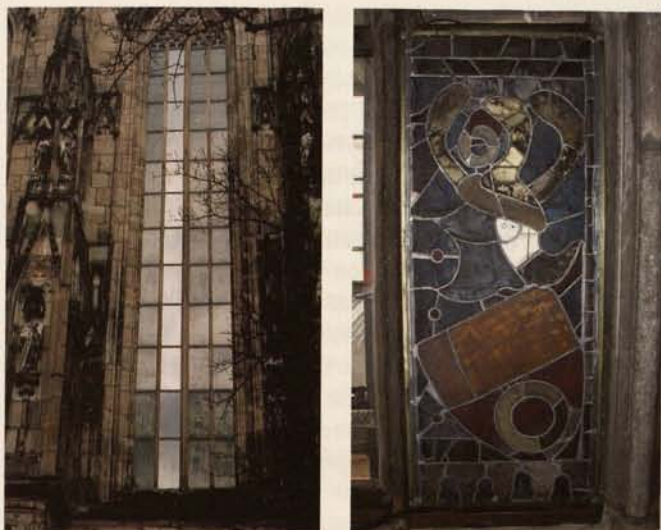
Abb. 25a-b. Nürnberg, St. Sebald, Fenster sV und nIV: Reflexionswirkung einer außen angebrachten Sonnenschutzfolie (a) und Verlegung eines elektrischen Heizkabels zur Spalttemperierung (b).
