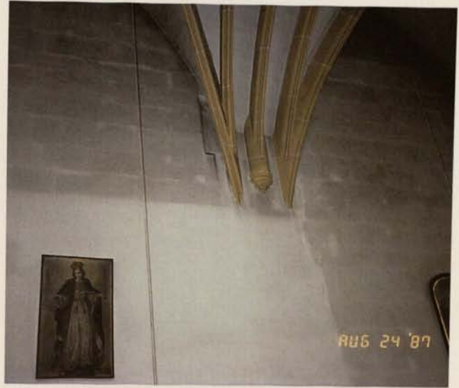
Abb. 8. Starke Verschmutzung der Raumschale infolge zu kalter Wandoberfläche, verdeutlicht am Unterschied des geringen Verschmutzungsgrads im Bereich der angebauten und damit „wärmenden“ Sakristei.
