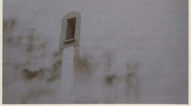
Abb. 8a. Nordfassade eines Kirchturms (s. Abb. 8b), Ausschnitt: Verschwärzungen nur an leicht nach oben geneigten Stellen des unebenen Fassadenputzes; fehlender Bewuchs im Regenschatten des kleinen Fensterblechs (20.3.2003).
