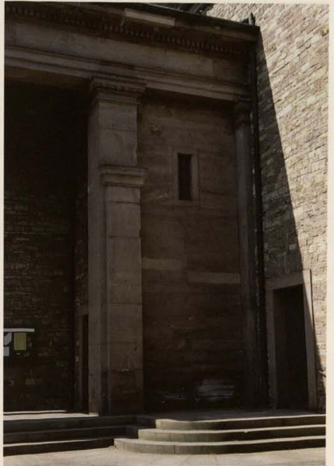
Abb. 12. Karlsruhe, katholische Stadtpfarrkirche: Feuchte- und Salzbelastung des Sockelmauerwerks durch falsche Dimensionierung der Regenrinnen.
