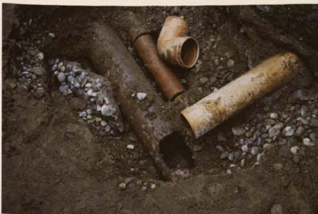
Abb. 11. Neudenu, Wallfahrtskirche: nicht sachgemäß angeschlossenes Fallrohr, das zur Durchfeuchtung der nördlichen Außenwand geführt hat.
