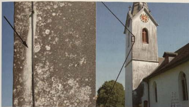
Abb. 9a-b. Westfassade eines zuletzt 1986 renovierten Kirchturms: Dunkle Verfärbung der hellen Tünche in den beregneten Bereichen (b), während im Regenschatten oder bei Kupferanteilen im Ablaufwasser der Bewuchs verhindert wird (a: Pfeil; Sommer 2004).
