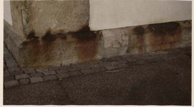
Abb. 15. Sulzgries, evangelische Kirche, Sockelmauerwerk: Rostfahnen infolge korrodierter Edelstahlplatten, die in Kontakt mit feuchtigkeits- und chloridbelastetem Mauerwerk waren.
