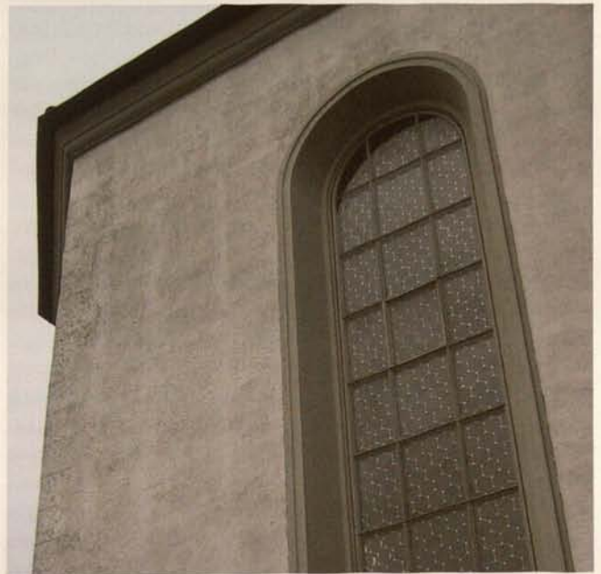
Abb. 6. Nördliche Seitenkapelle einer Kirche, Westfassade: dunkle Verfärbungen im oberen Teil, die zunächst fälschlich als Abwaschung der Tünche interpretiert wurden (20.3.2001).
