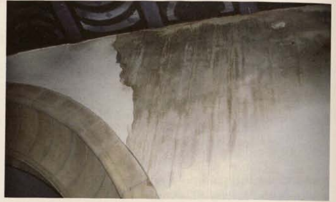
Abb. 4. Gaggstadt, evangelische Kirche, Chorwand und bemalte Holzdecke, Detail: nachhaltige Durchfeuchtung durch eindringendes Regenwasser aufgrund offener, undichter Glockenstube.
