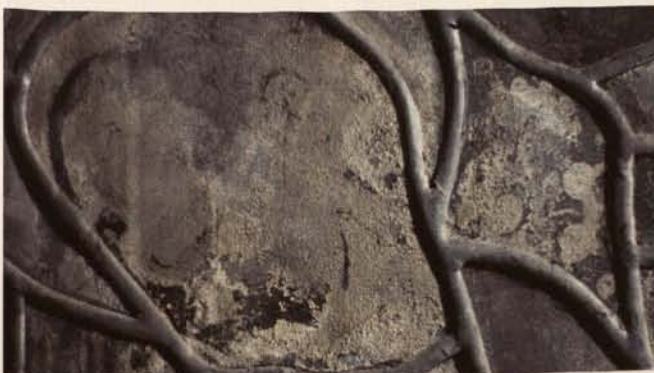
Abb. 3. Nürnberg, St. Sebald, Fenster nIV (sog. Fürer-Fenster), Detail: Nachwachsen der Glaskorrosion infolge der Kondenswasserbelastung.
