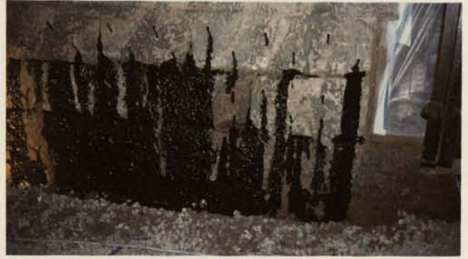
Abb. 17. Calw, evangelische Stadtkirche, Sockel: durch Bitumeninjektion verunreinigte Wandoberfläche.
