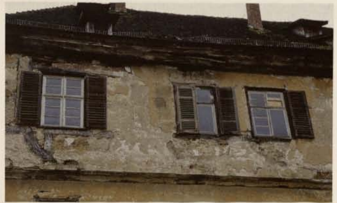
Abb. 6. Königsberg, Wasserschloss, Südfassade, Ausschnitt: ausgeprägte Schäden an Außenputz und hölzerner Traufe aufgrund Undichtigkeit im Dach.
