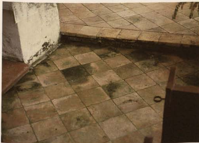
Abb. 7. Praktischer Nachweis des „Wassergewinns“ bei falscher Lüftung zur falschen Zeit.
