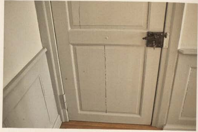
Abb. 25. Nürnberg, Johannisstraße 19, erstes Obergeschoss: Türblatt mit Schwundschäden aufgrund von Betriebsfehlern in der Handhabung des Heizsystems (2004).
