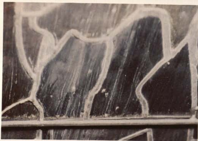
Abb. 6. Nürnberg, Frauenkirche: massive Kondenswasserabläufe an den Rückseiten der historischen Verglasung.
