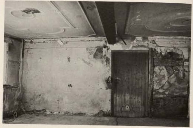
Abb. 19. Kucha, Haus Nr. 18, Mühlengebäude, Erdgeschoss: Stube vor der Instandsetzung (2000).
