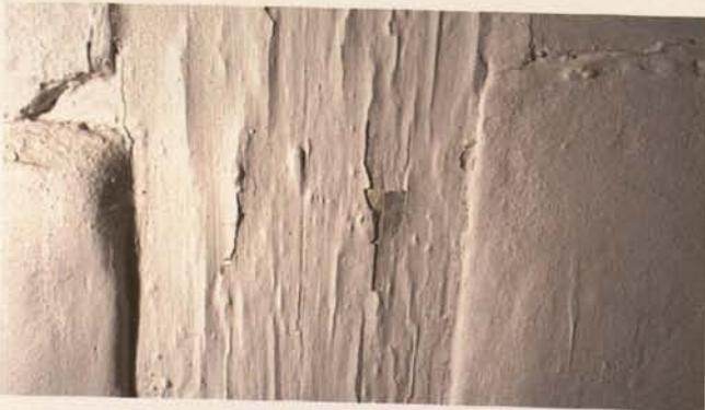
Abb. 13. Fürth, Königstraße 89, erstes Obergeschoss: Farbabhebungen an Holzflächen (Fachwerk und Balken-Bohlen-Decken) aufgrund nicht abgestimmter Eingriffe in die Regeltechnik des Heizsystems (2004).
