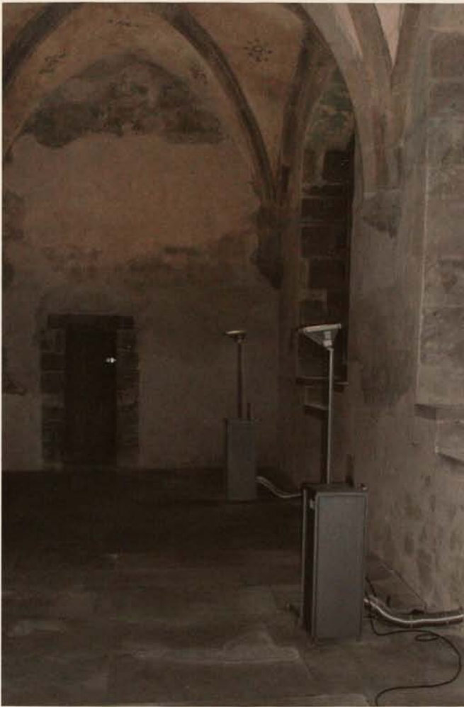
Abb. 5. Maulbronn, Kloster, Dormentbau, Laienrefektorium: Lüftergehäuse für den Dauerbetrieb mit Integration funkbasierter Messbaugruppen.
