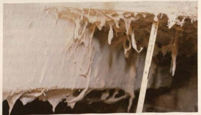
Abb. 5. Luftfeuchtebedingter Bauschaden: schwammbefallene Deckenkonstruktion.
