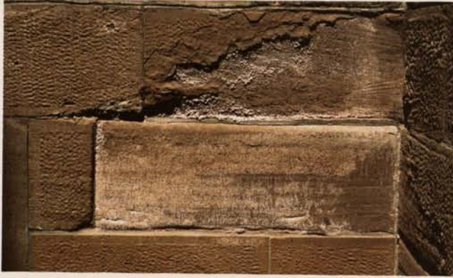
Abb. 1. Calw, evangelische Stadtkirche, Quadermauerwerk, Detail: Schalenbildung und Absanden der Oberflächen durch Kristallisation bauschädlicher Salze.
